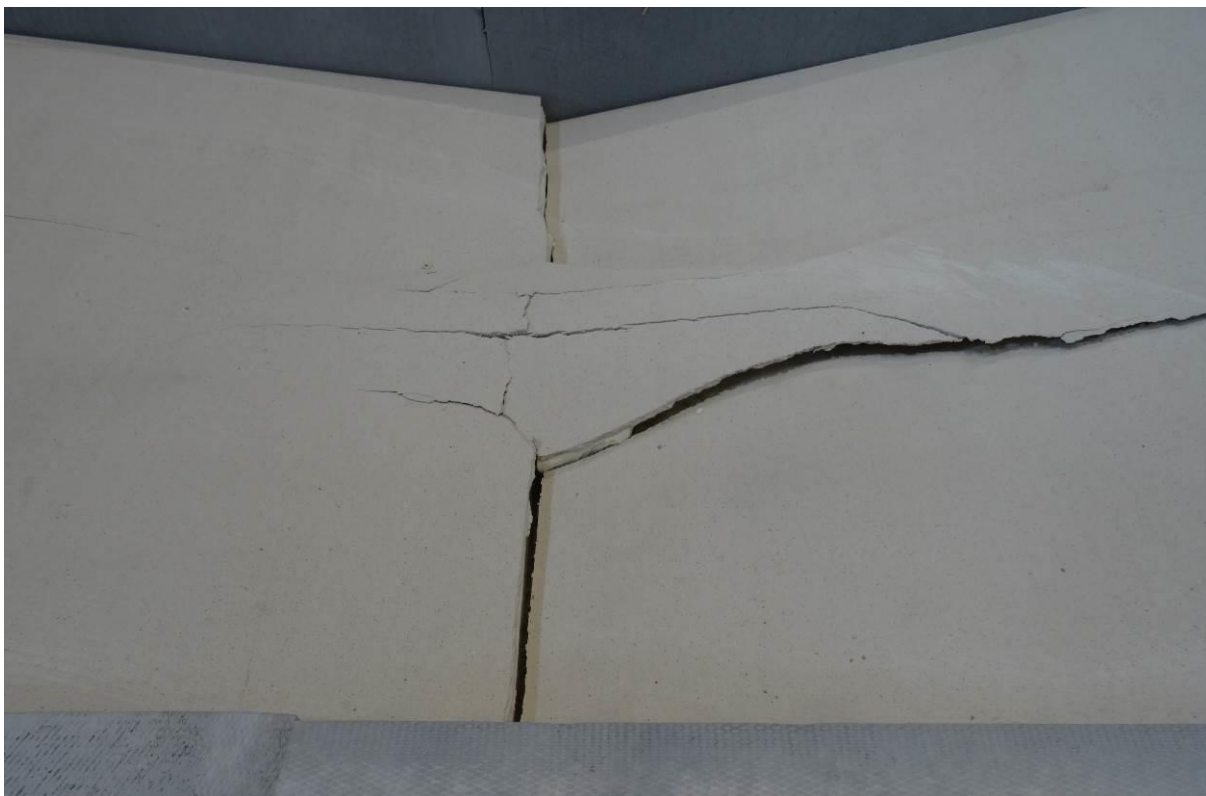
Obr. 14 Vzorek 2 (s ocelovou výztuhou) poškozený celoplošným zatěžováním – detail (shora).
